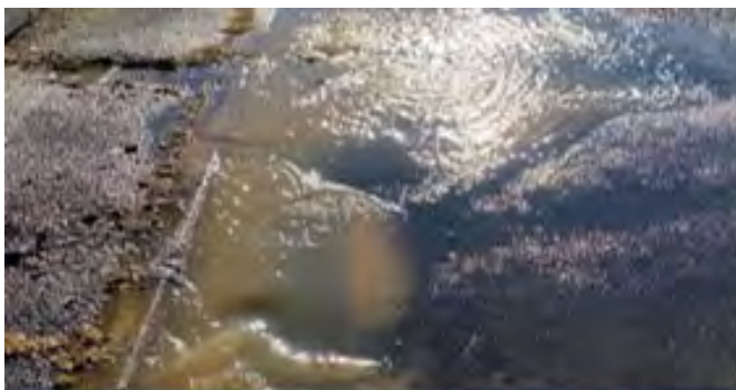
Fuite rue Lulli – Rupture de canalisation
